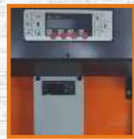
Ηλεκτρονικός πίνακας ελέγχου
